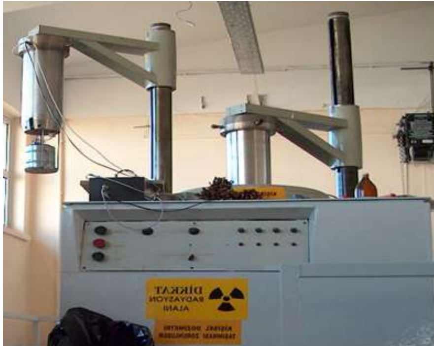
Şekil 2.5. Araştırmada kullanılan TAEK-SANAEM'de bulunan ^{60}\text{Co} gamma kaynağı.
